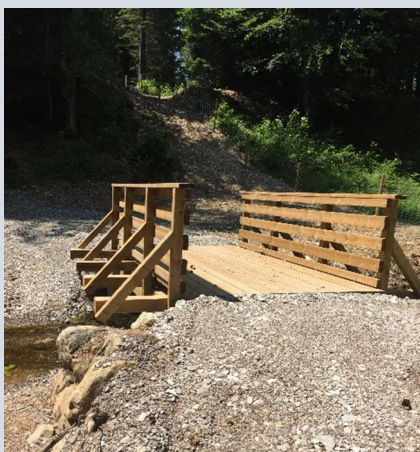
Figura 28 - Area faunistica di Forni di Sopra - Ponticello costruito con tecniche di inaeaneria naturalistica
