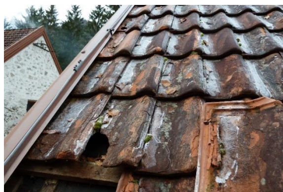
Figura 2 - Villa Emma prima della ristrutturazione (dettaglio dello stato del tetto)
