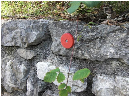
Figura 34 - Sistema RDS - Tag installato su un'opera
