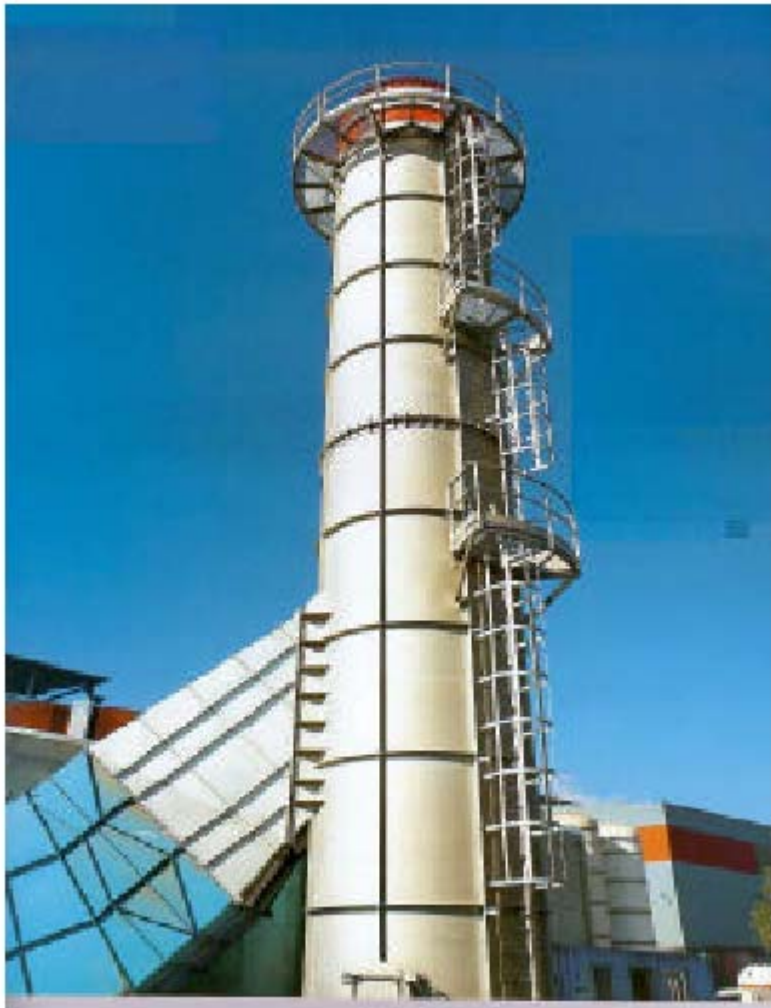
Figura 6: Impianto di abbattimento e captazione fumi della ABS
