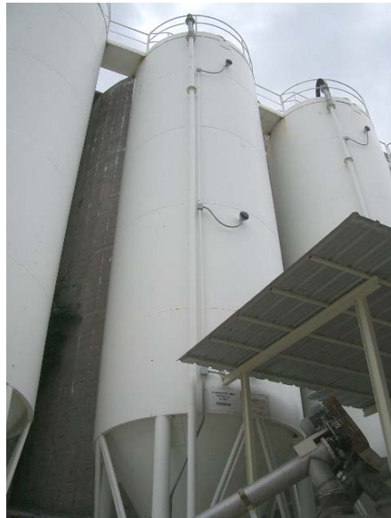
Silos per lo stoccaggio delle sabbie
