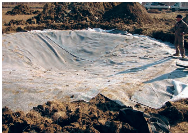
Messa in opera con la stesura del geotessuto tipo “Bentomat” sul fondo Bacino N. 1.
