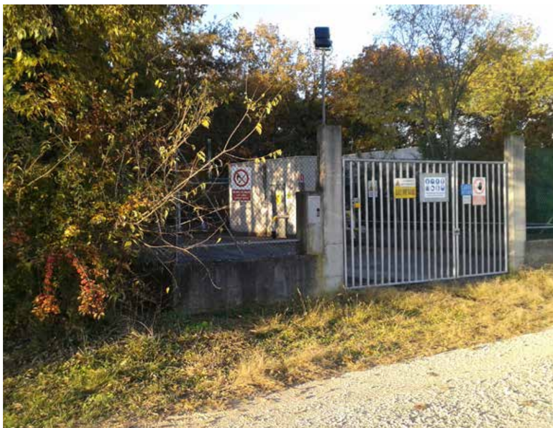
7. Sul limite sud della zona boschiva è stata collocata una centralina del metanodotto che passa nei pressi del tumulo.
