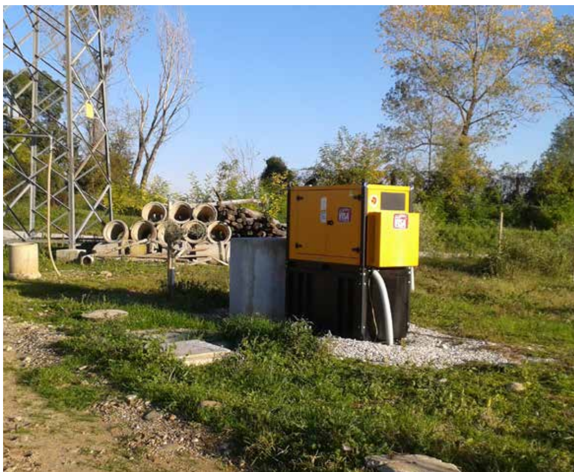
10. La centralina e tubazioni in cemento riposte nei pressi del palo della linea elettrica.
